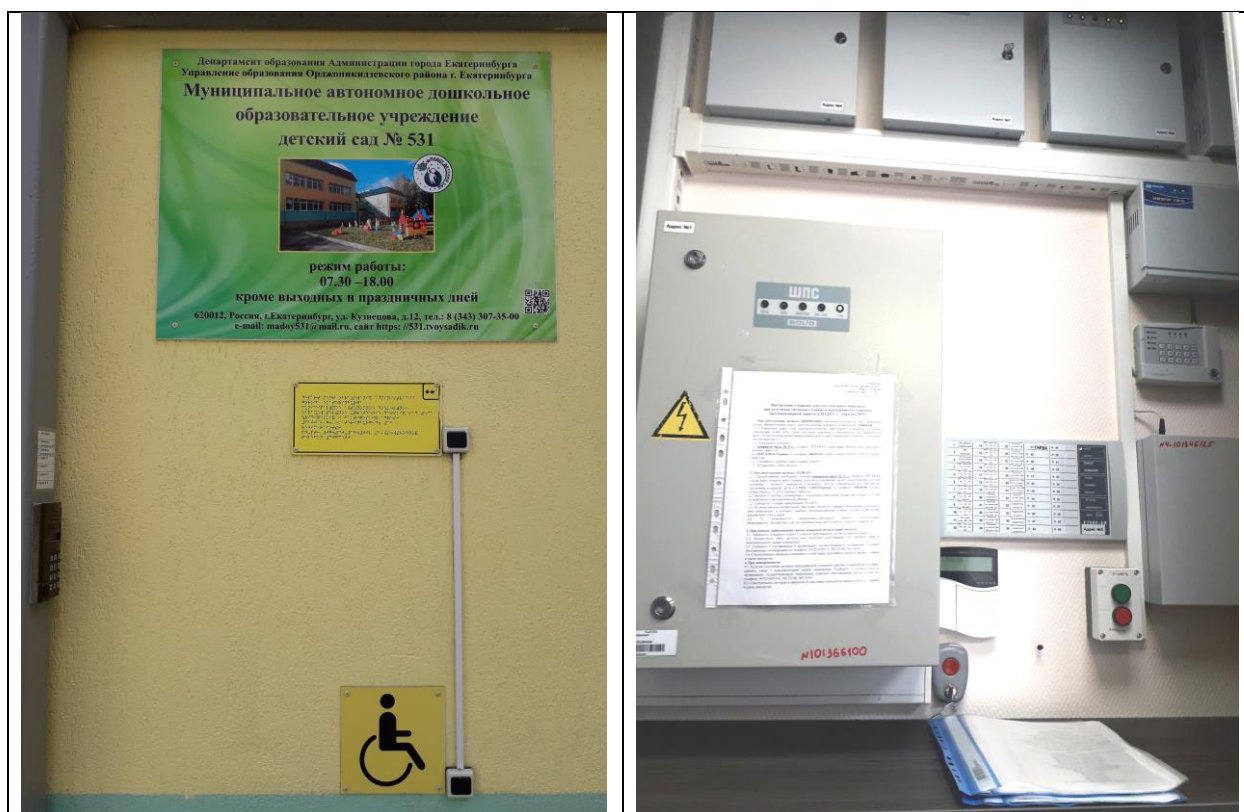
Рисунок 10. Автоматизированные электронные системы, обеспечивающие высокую степень надёжности. МАДОУ детский сад № 531, г. Екатеринбург
